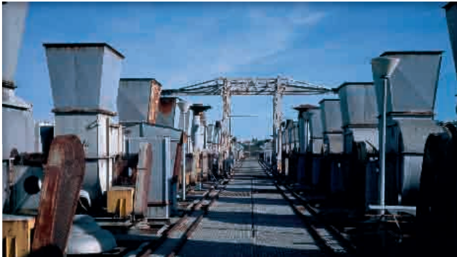
Les extracteurs d'air de la peinture alignés au sommet de l'île Seguin. © Renault Communication / Photo Pierre Z.
